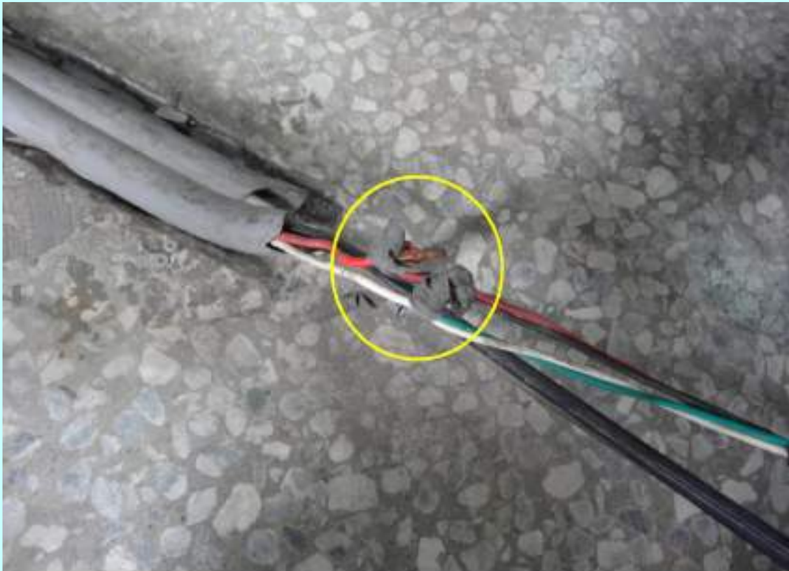
照片 2 地面插座電線裸露之情形
